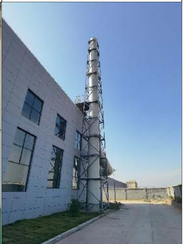
25m 高排气筒(2#)
