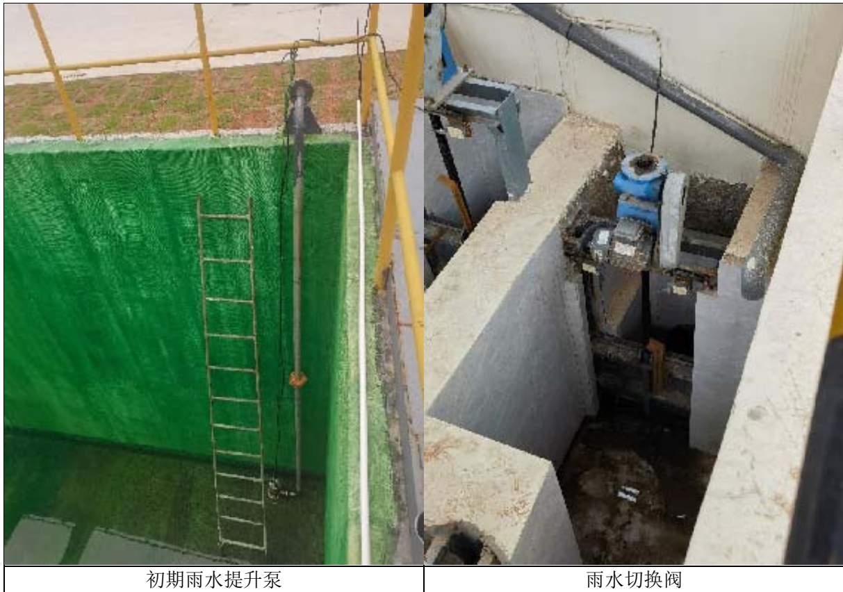
图 4.1-2 初期雨水收集池
