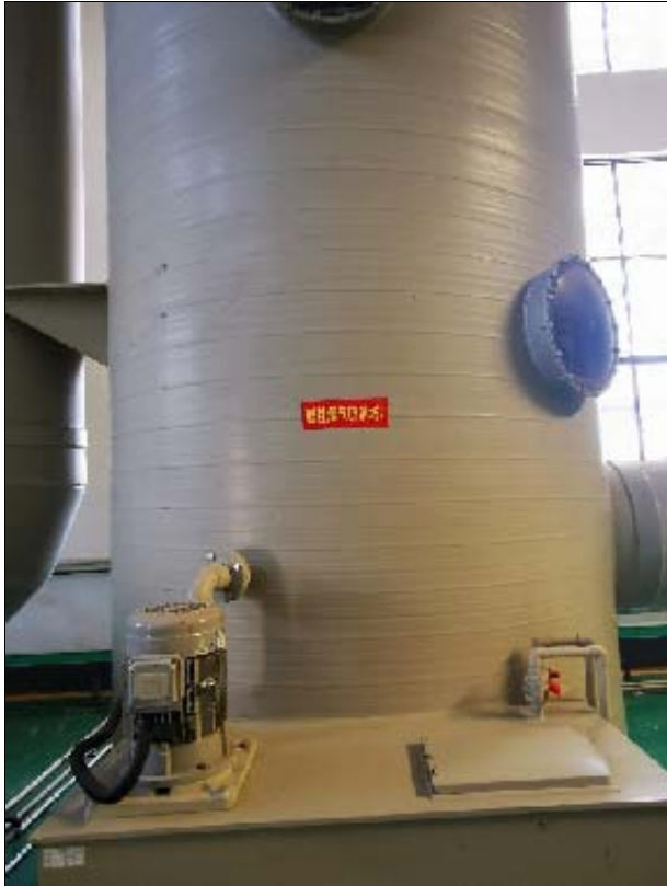
含氨废气-酸液喷淋塔 3#
