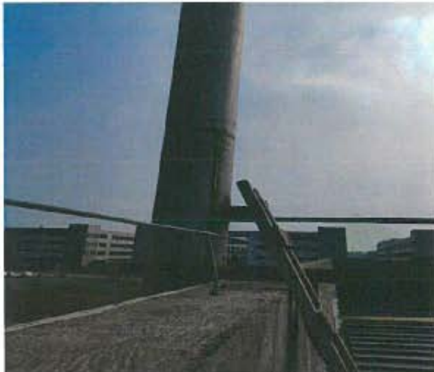
G9 3#燃气锅炉烟气烟囱 DA003-1
