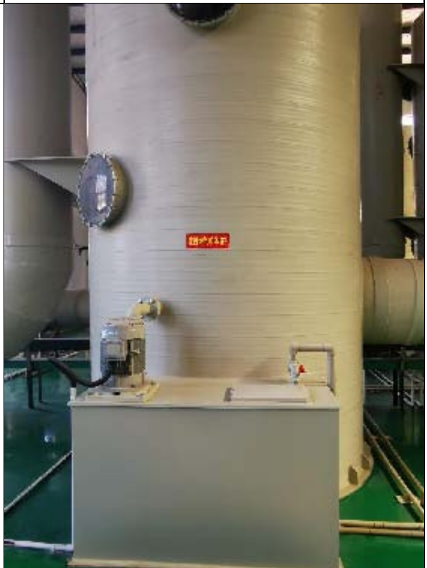
酸性/有机废气-碱液喷淋塔 3#
