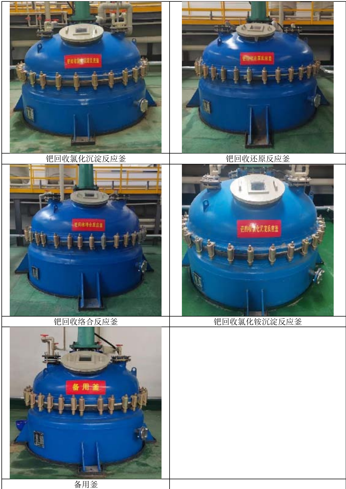
图 3.3-2 钚回收系统主要设备现场图片
