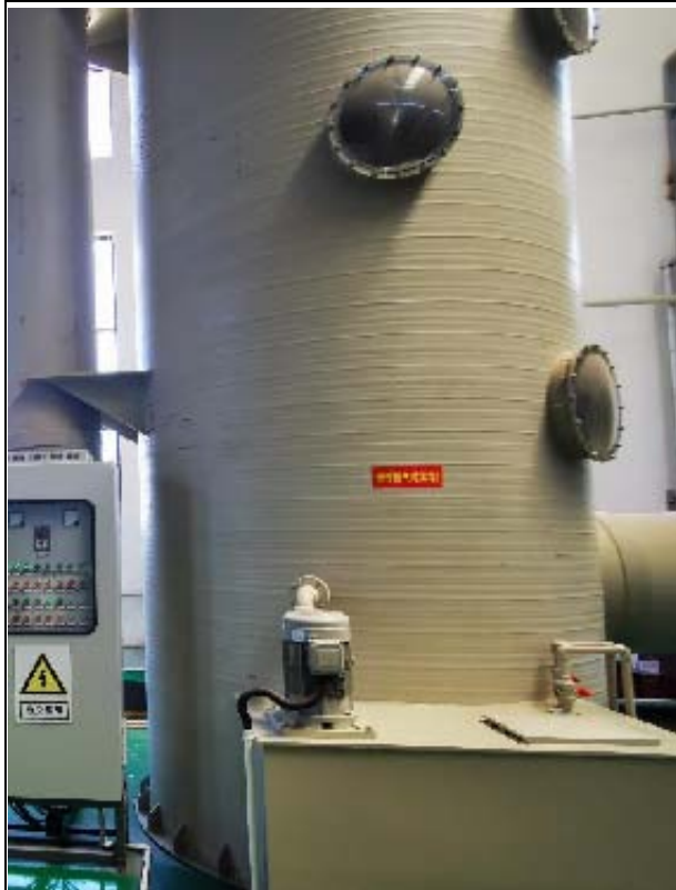
含氨废气-碱液喷淋塔 1#
