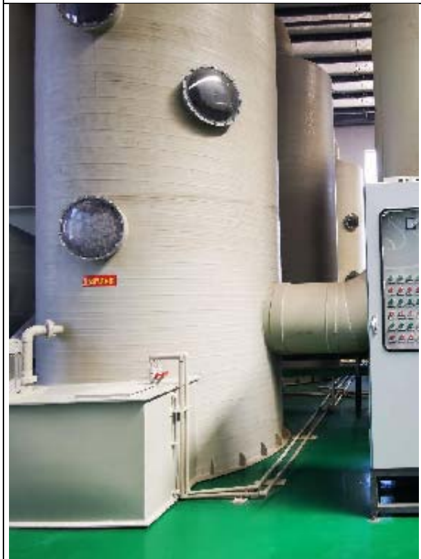
酸性/有机废气-碱液喷淋塔 2#
