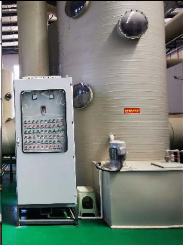
酸性/有机废气-碱液喷淋塔 1#
