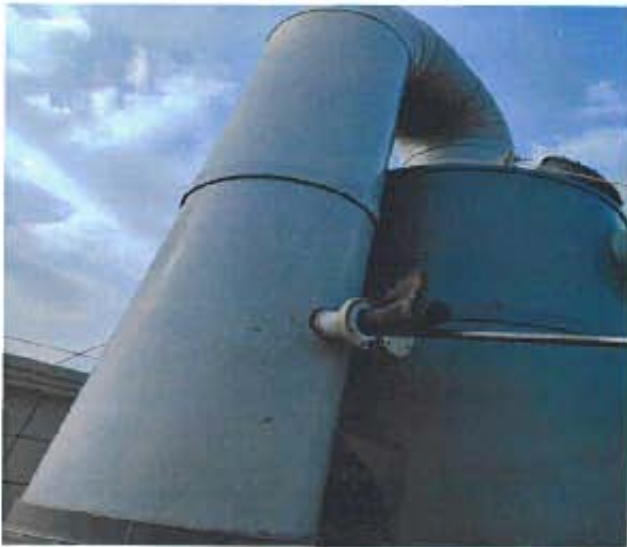
G15 实验室废气处理措施后 DA006-2
