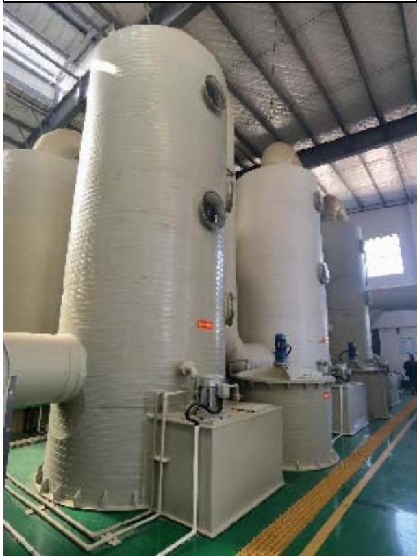
废气处理车间
