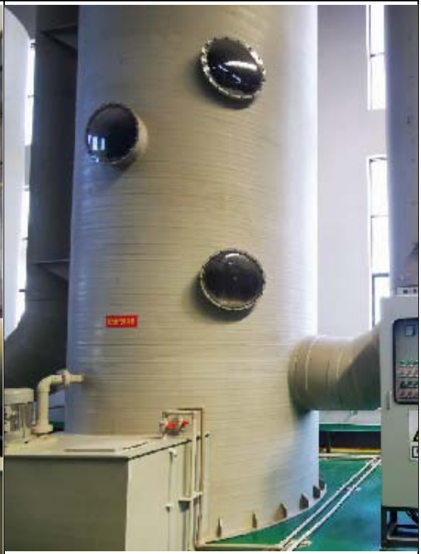
含氨废气-酸液喷淋塔 2#
