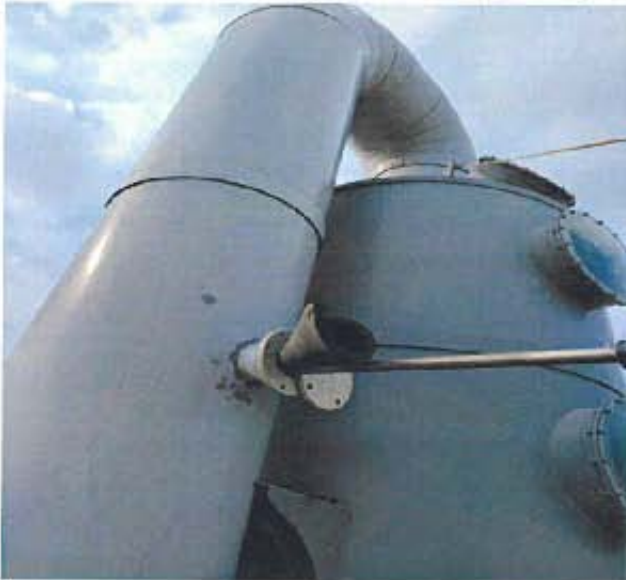
G13 实验室废气处理措施后 DA005-2
