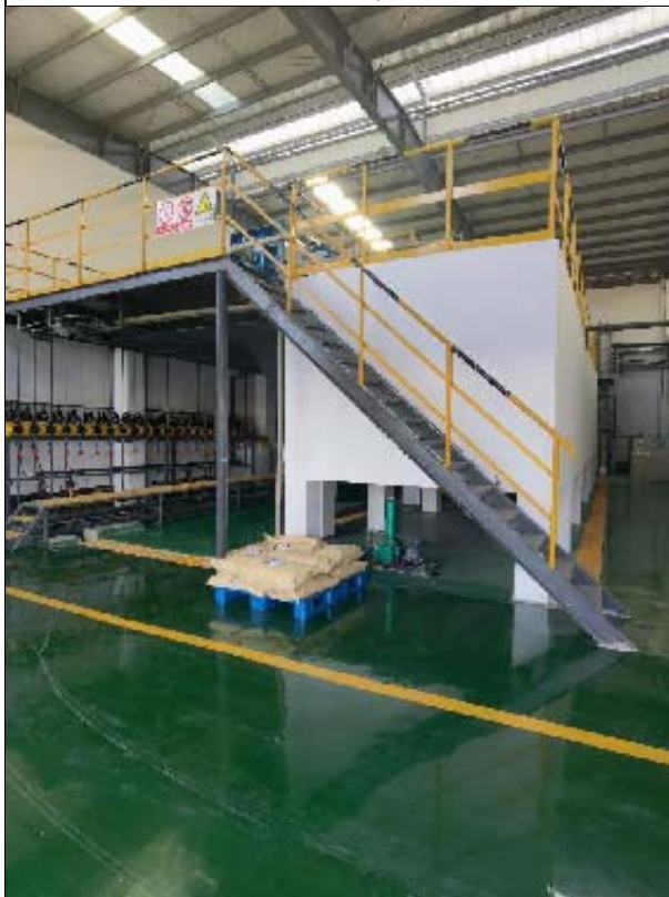
水池及加药设备
