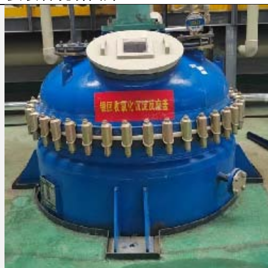
银回收氯化沉淀反应釜 1#
