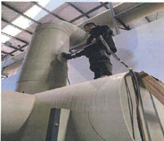
G5 含氰废气治理设施处理前（三级碱液喷淋塔前） DA002-3
