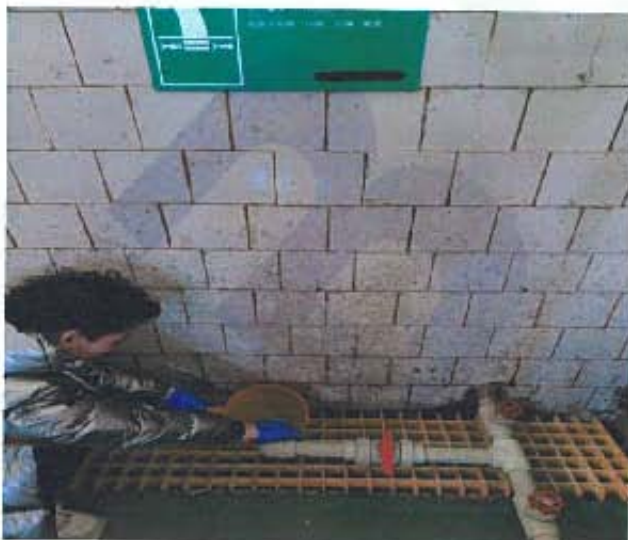
W1 车间废水排放口 DW001-2
