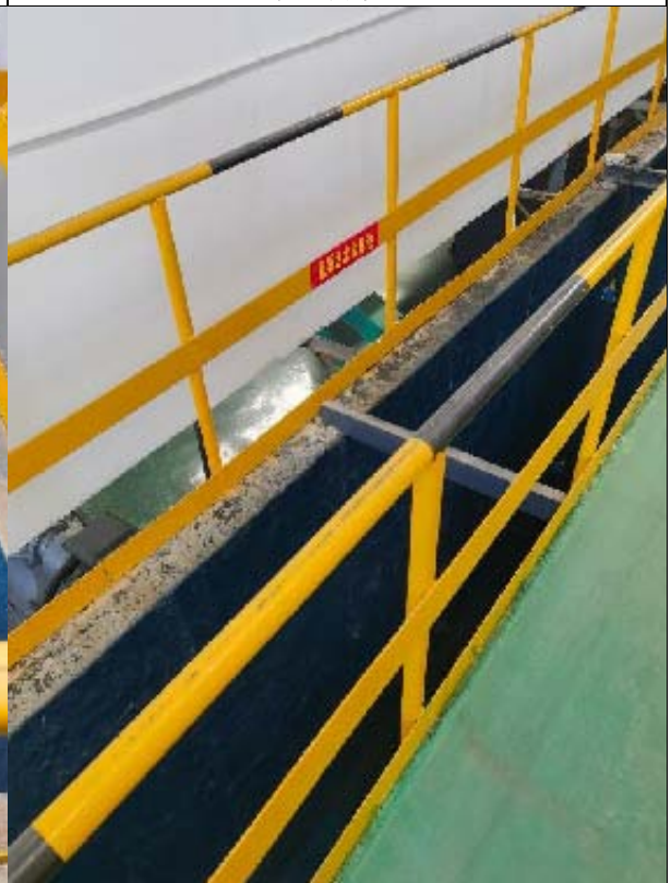
氨氮废水收集池
