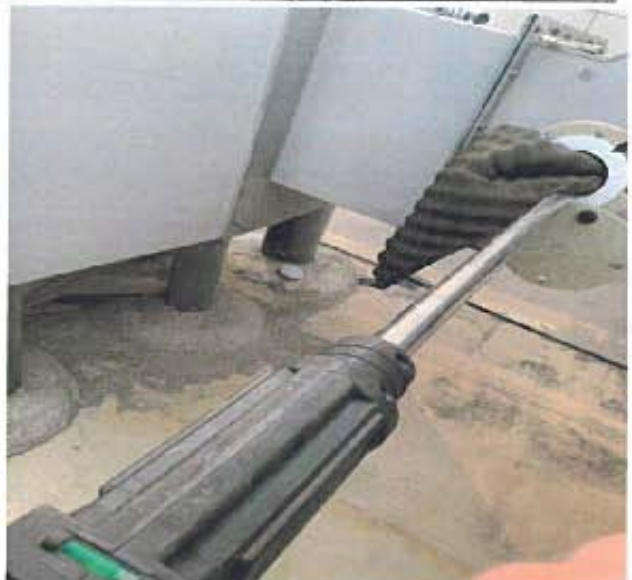
G14 实验室废气处理措施前 DA006-1
