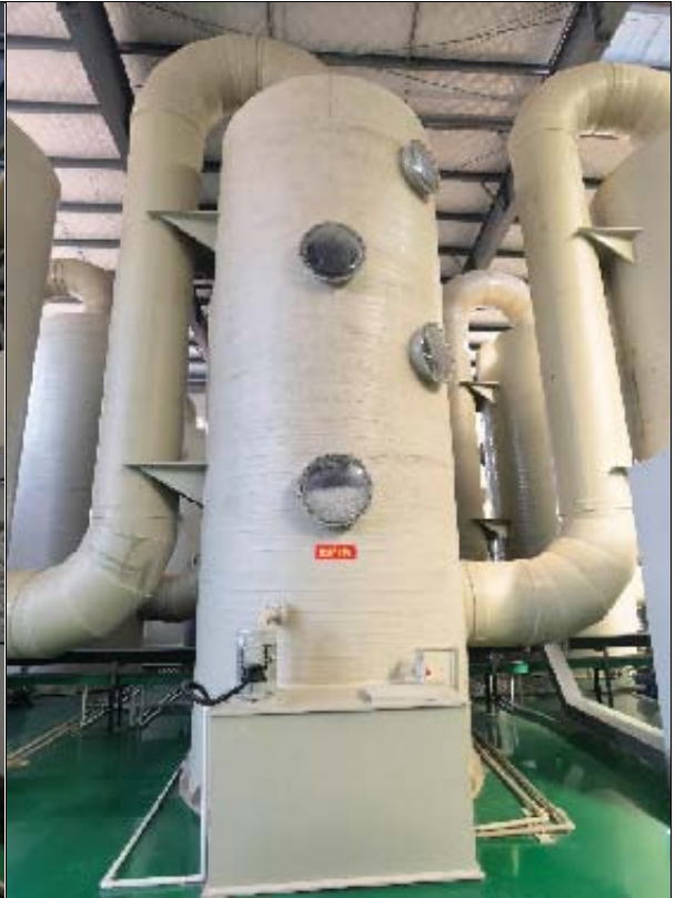
含氰废气-碱液喷淋塔 2#
