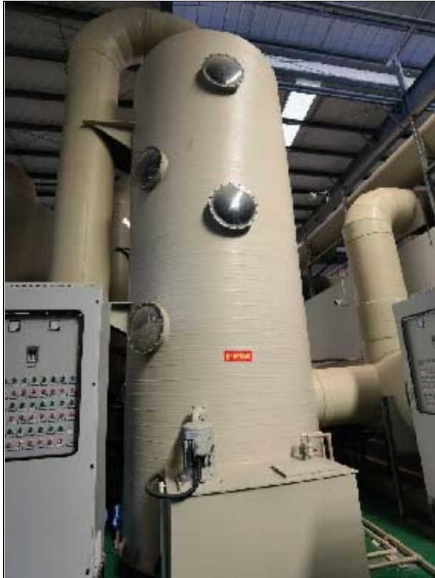
含氰废气-碱液喷淋塔 1#
