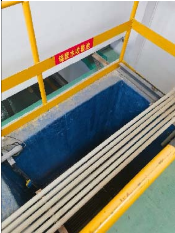
镍废水收集池
