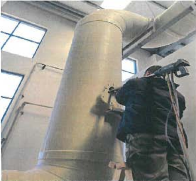
G7 含氨废气治理设施处理前 (一级碱液喷淋塔前) DA002-5
