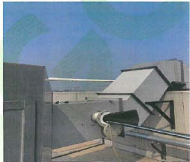
G10 实验室废气处理措施前 DA004-1
