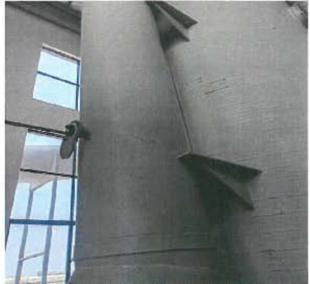
G8 含氨废气治理设施处理后 (两级酸液喷淋塔后) DA002-6
