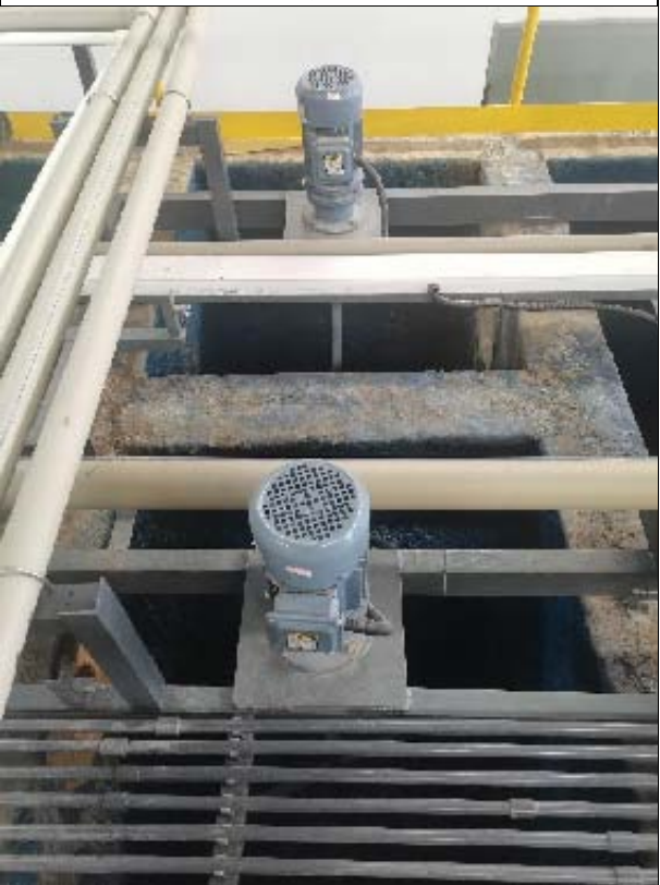
初期雨水搅拌设施
