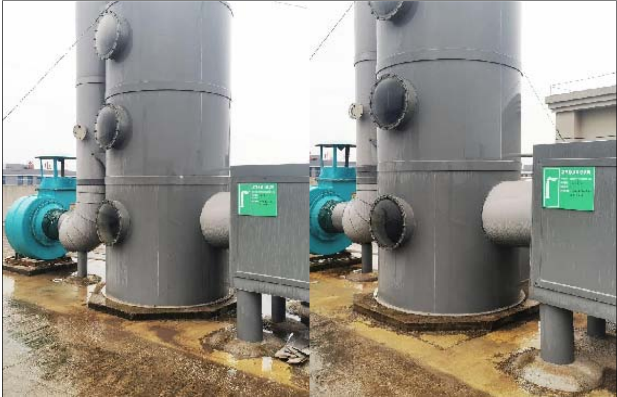
2#实验室废气排放口
