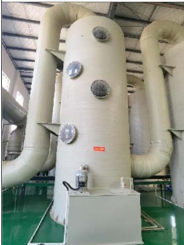
含氰废气-碱液喷淋塔 3#
