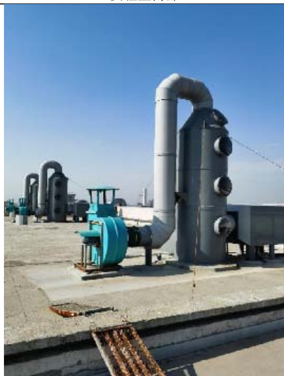
活性炭吸附+碱液喷淋塔
