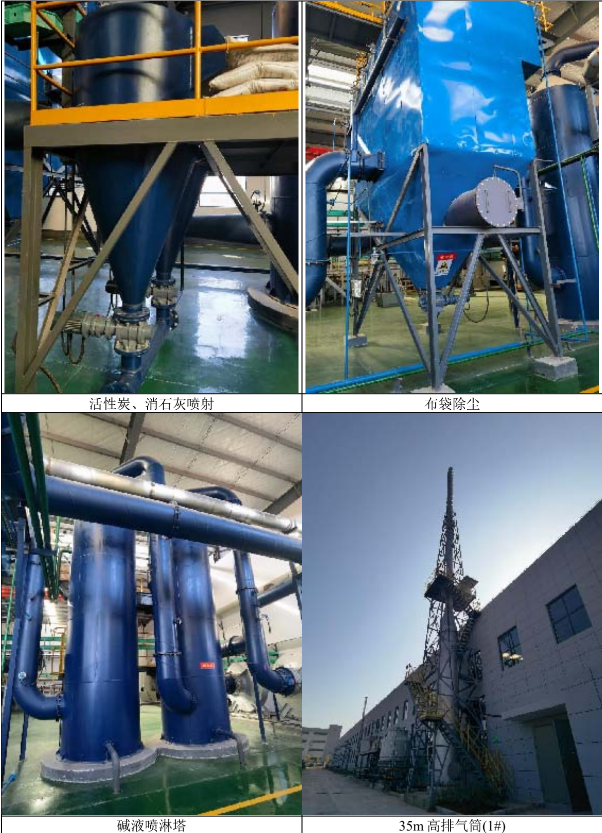
图 4.1-5 预处理烟气治理措施
