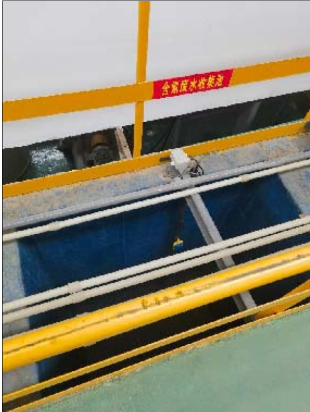
含氰废水收集池
